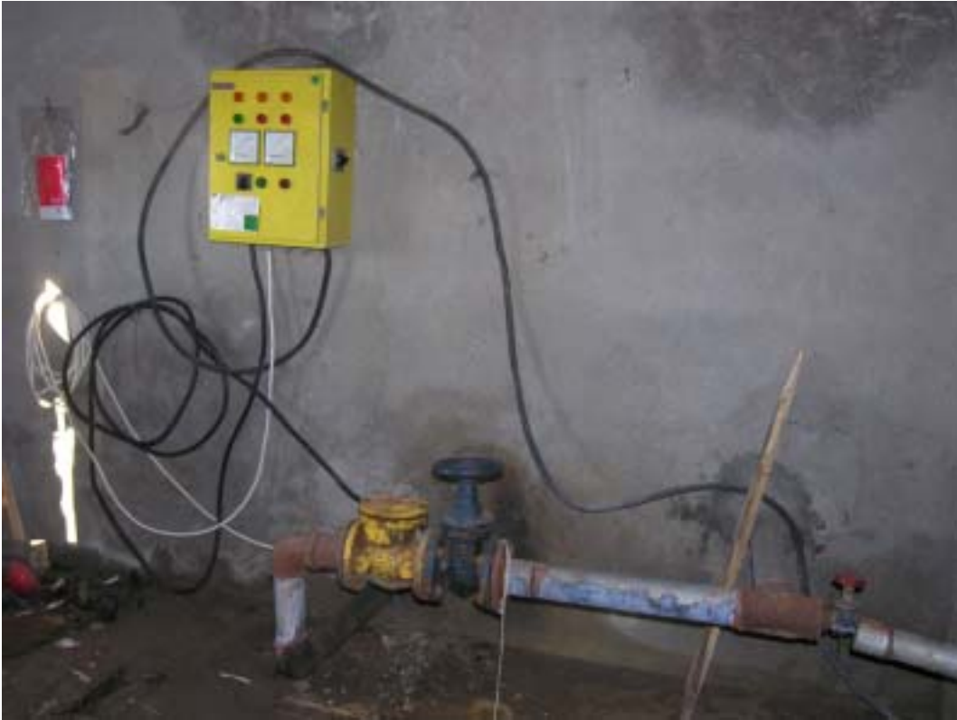
Şekil 26. Köy kuyusundaki elektririk pompası.
